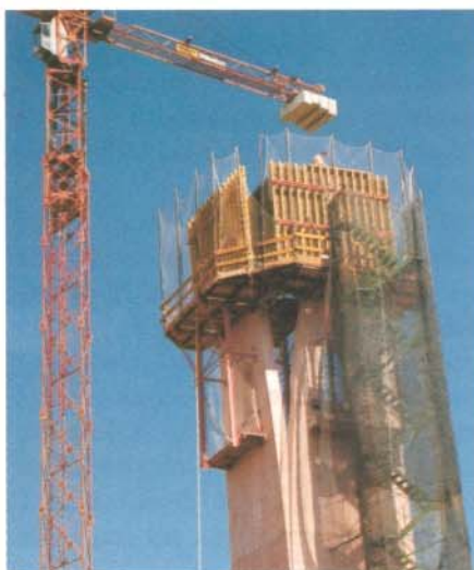
Patología de la edificación, tema a tratar.
