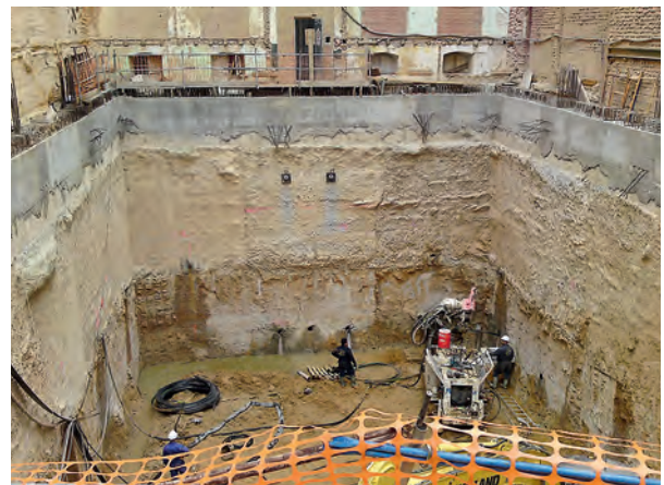
Fig. 3: filtración por el anclaje del terreno.
