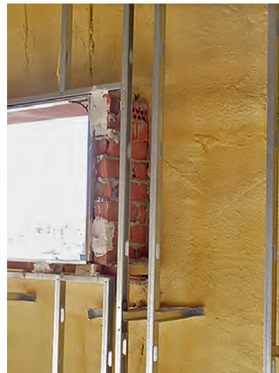
Fig. 1: vista de la aplicación de espuma de poliuretano proyectado, sobre la que se monta un trasdosado autoportante de placas de yeso laminado.
