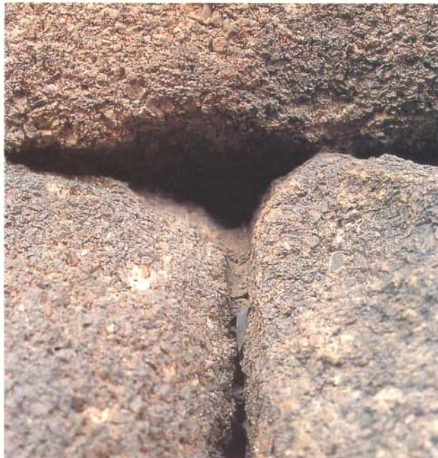
Muchos sillares están dañados.
