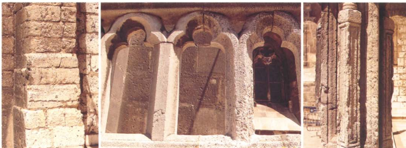
Imágenes de distintos puntos donde es visible el deterioro de estos monumentos.
