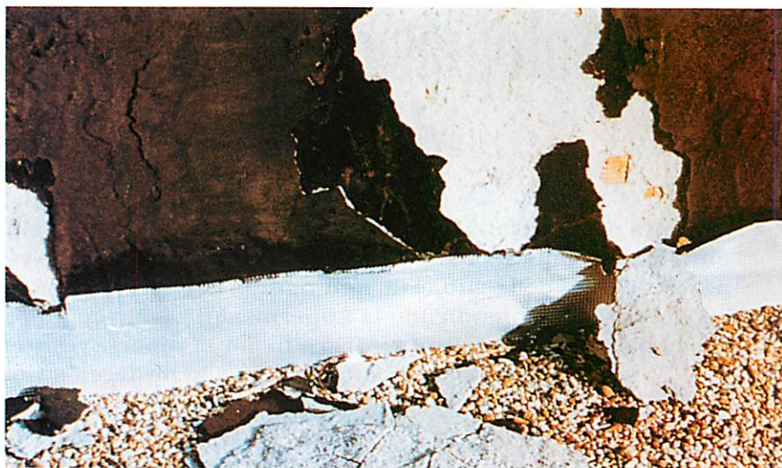
Problemas con la entrega de la impermeabilización en paramentos verticales.
