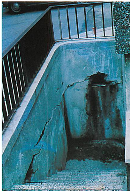
Entrada de agua en salida a la cubierta.
