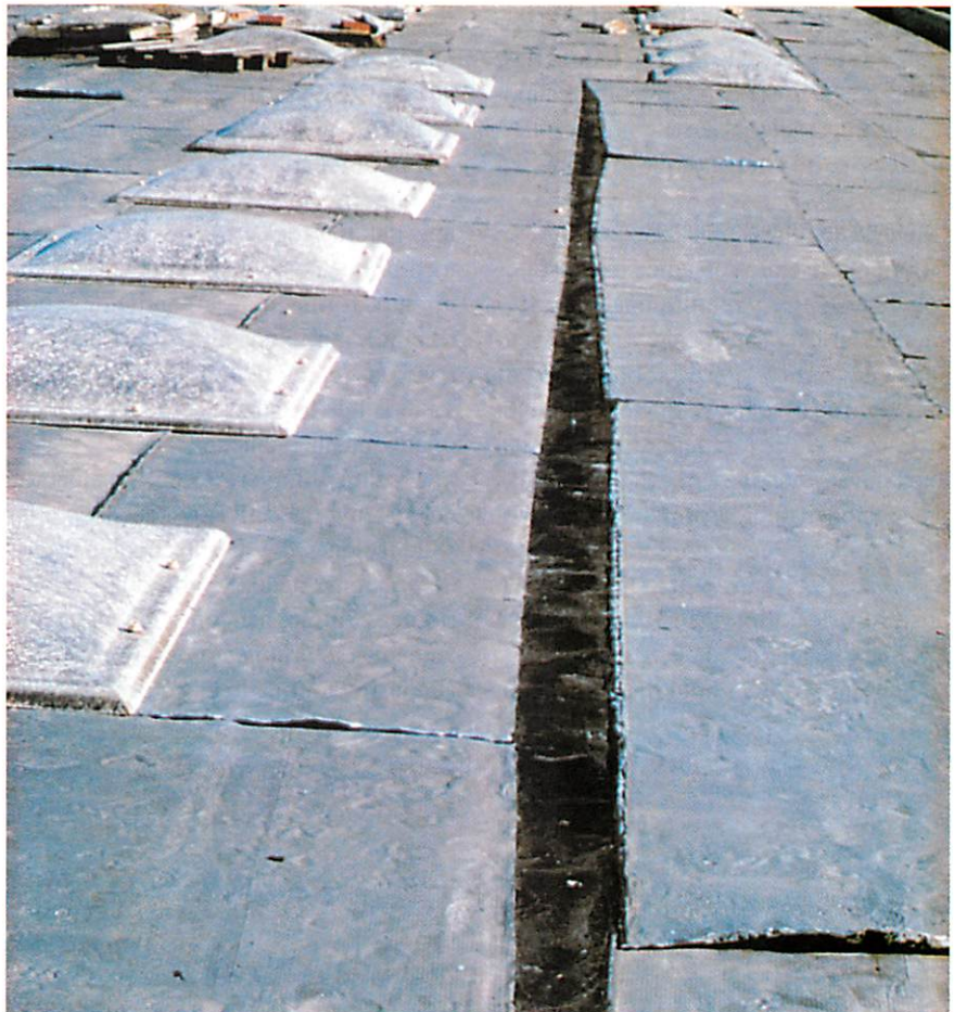
Deslizamiento de la impermeabilización asfáltica por dilataciones térmicas.
