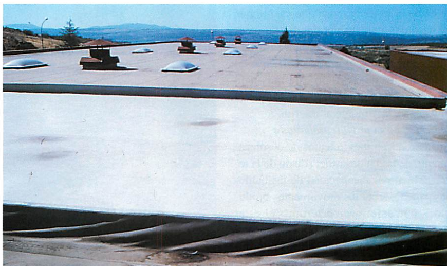
Arrugas previas a la rotura de una lámina de PVC.
