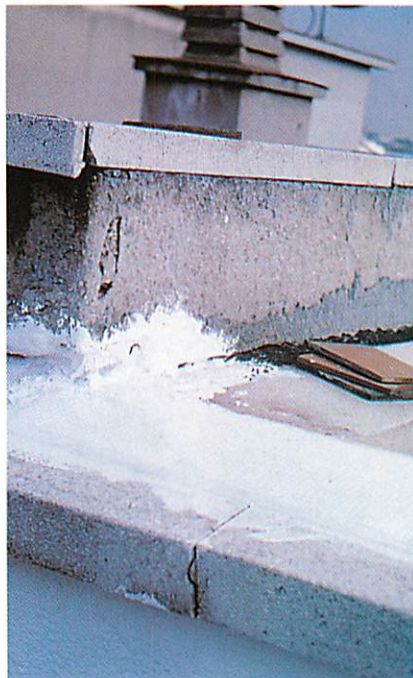
Deterioro de material de unión.
