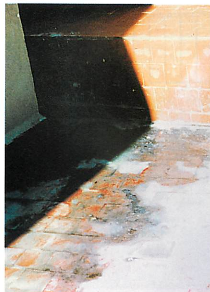
Mala disposición de desagües.
