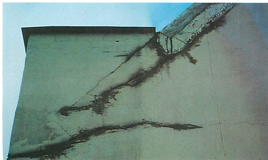
Grietas en el forjado soporte de la cubierta.
