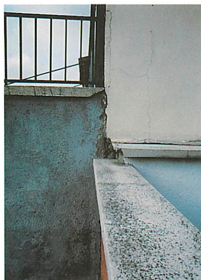
Grietas verticales en el peto.
