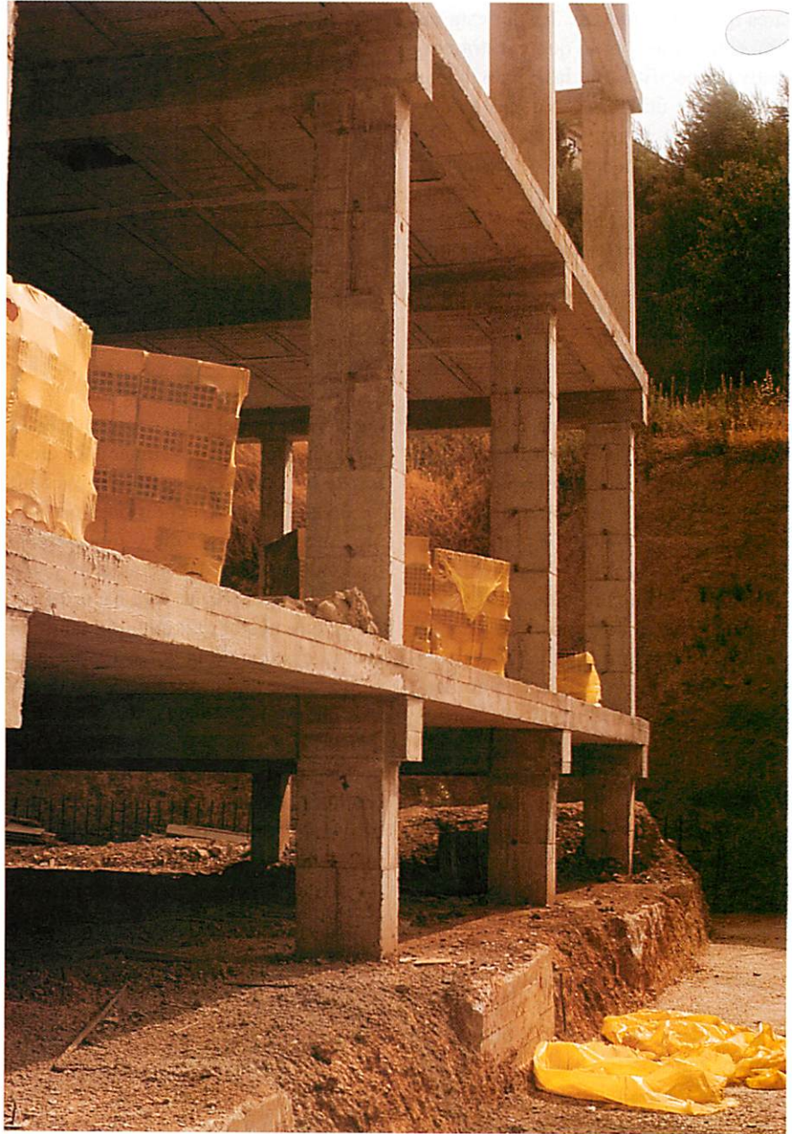
Pilar corto. Muy peligroso si se produjera un movimiento sísmico.
