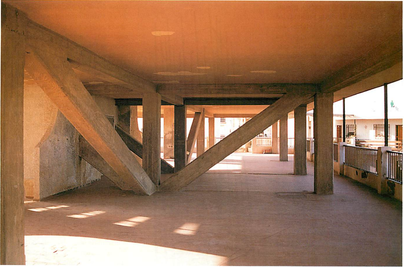
Arriostramientos de hormigón armado en dos direcciones ortogonales para absorción de cortantes por sismo.
