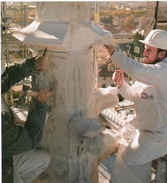
La degradación de los conjuntos estatuarios y ornamentales era generalizada.
