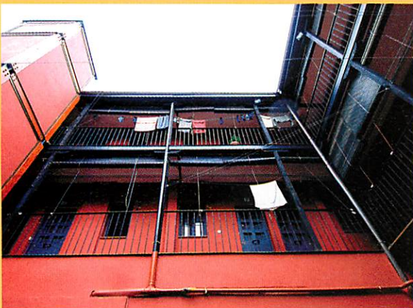
El objetivo de la rehabilitación es mejorar las condiciones de habitabilidad de los inmuebles sin que se pierdan sus elementos característicos.
