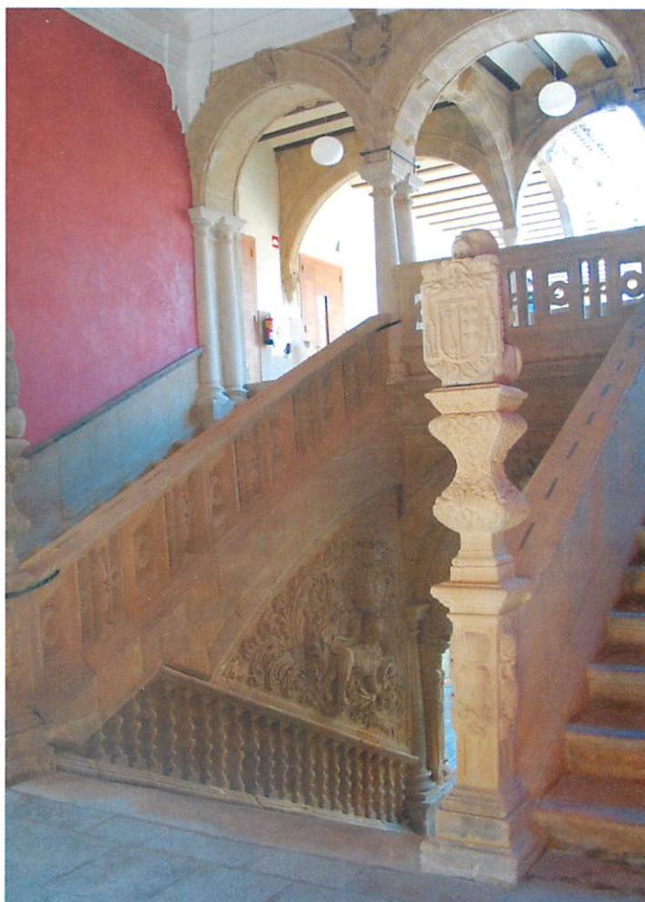
La piedra de la gran escalera barroca y de diferentes elementos ornamentales estaba gravemente deteriorada, fundamentalmente por humedades de capilaridad.
