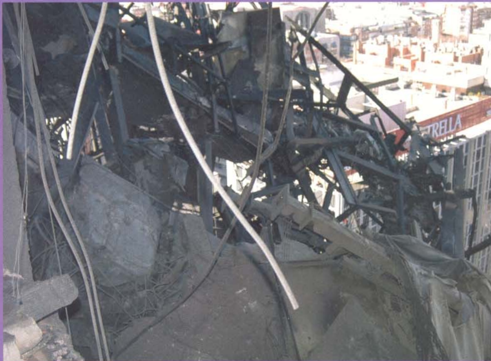
Las imágenes tras el incendio muestran la acumulación de escombros sobre la planta técnica y en el interior del rascacielos, así como en su zona de coronación.
