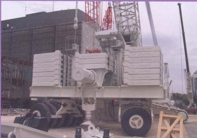
En la fotografía superior se observa la posición de las grúas. Abajo, contrapeso de la grúa de mayor tonelaje.
