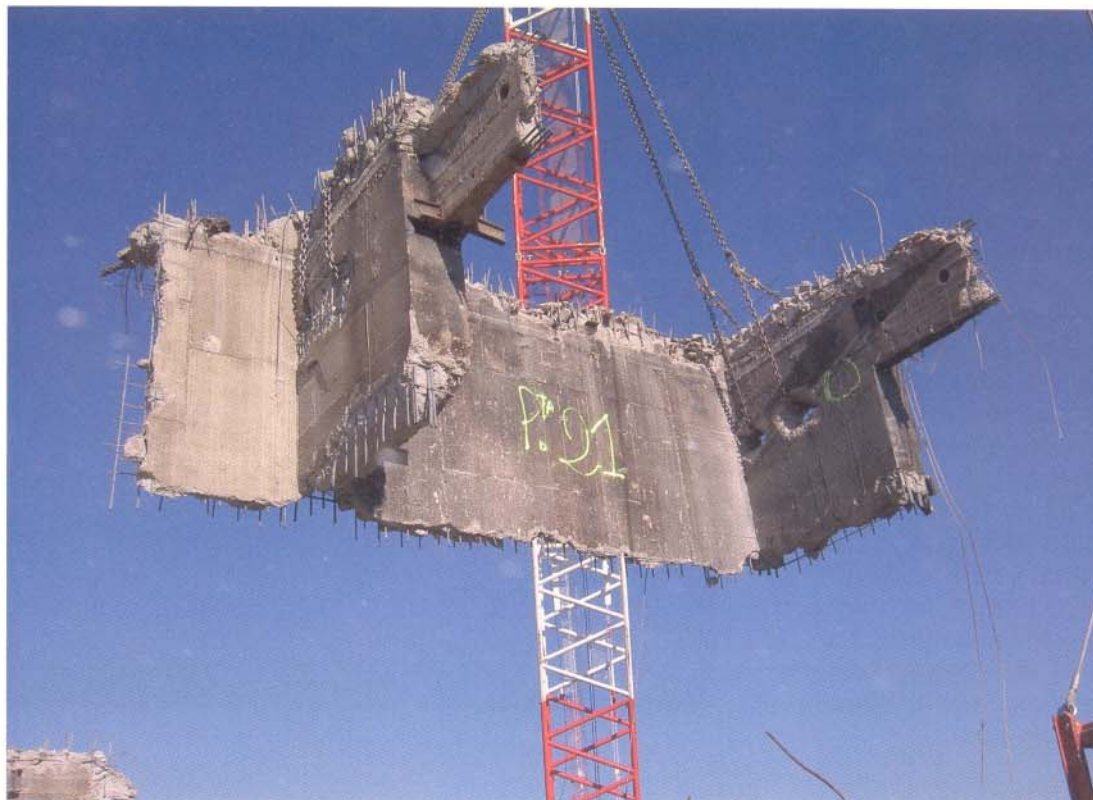
Impresionante pantalla de hormigón desmontada de las ruinas del edificio Windsor.
